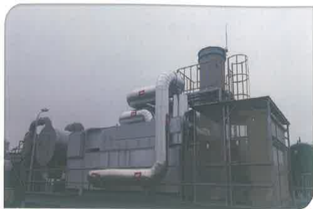
三床 RTO 项目名称：江苏长运电子 应用行业：喷漆涂漆
